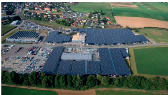
Installation photovoltaïque GEFCO à Courgenay
